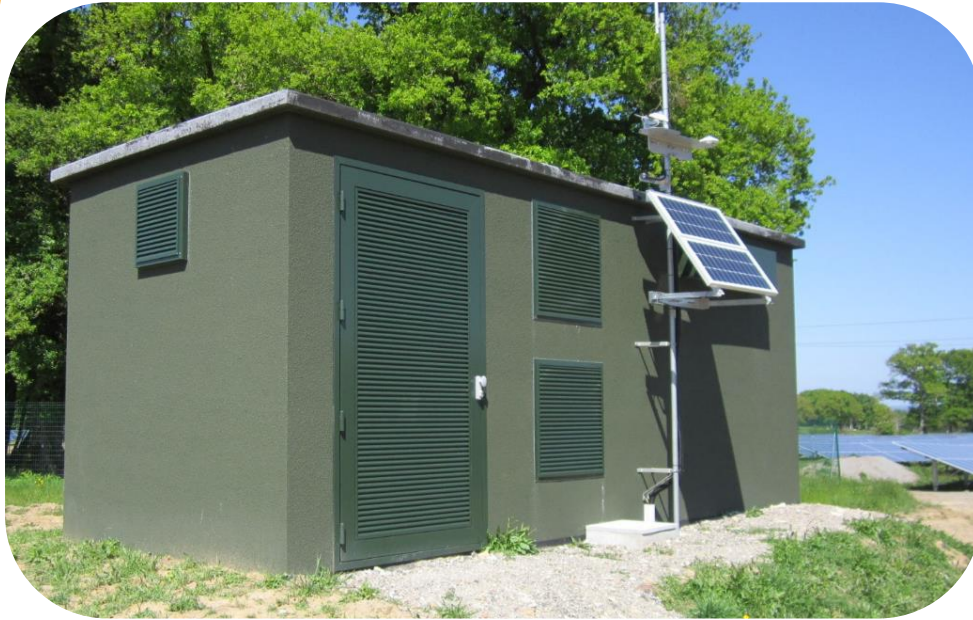
1 poste de livraison/transformation électrique : 20 m 2 d'emprise au sol 1 poste de transformation : 15m 2 d'emprise au sol
