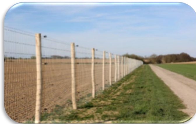
Installation d'une clôture de 2 m de hauteur type grillage maille carrée avec poteaux en bois. Mailles adaptées pour le passage de la petite Faune
