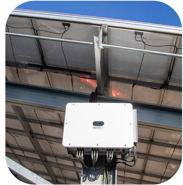
Exemple : onduleur décentralisé
